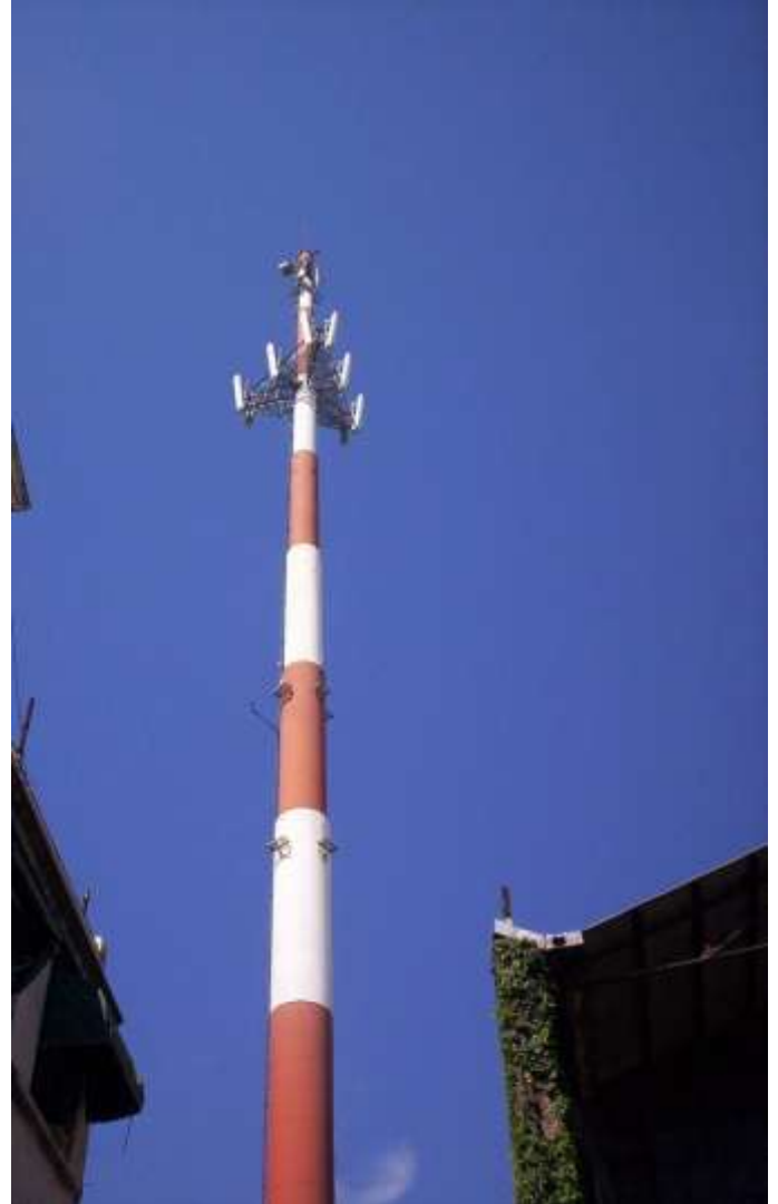
Foto II: Antenas montadas en Torre "monoposte"
